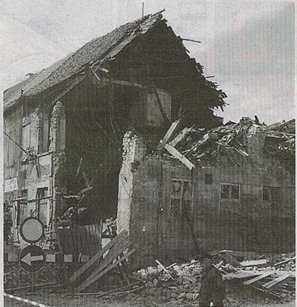
„Hotelowa” runęła niespodziewanie... Fot1. Andrzej Adamiak
